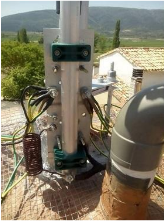
Aquí se puede observar el detalle de la bobina de choque stuck y radiales
